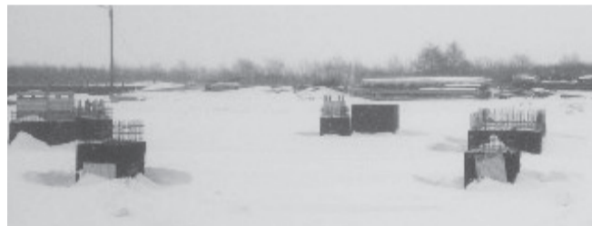
Так выглядит комплекс очистных сооружений в Охе...
